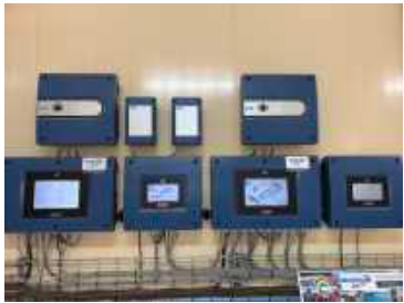
Boitiers de Gestion Ventilation + alarme
